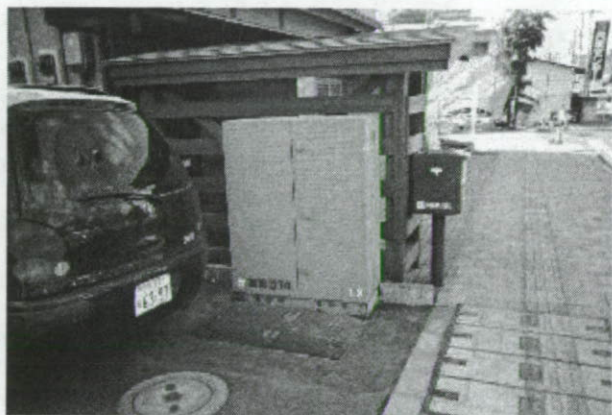
電線地中化のための地上機は民有地に置かれている
